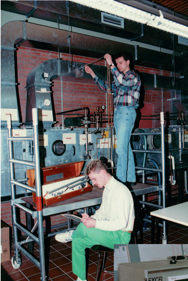
Funktionsmessungen an einer Klimaanlage
