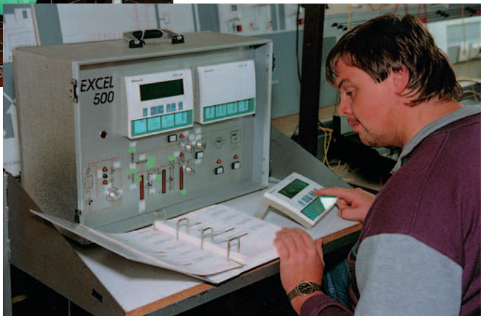
Station einer Gebäude- managementanlage
